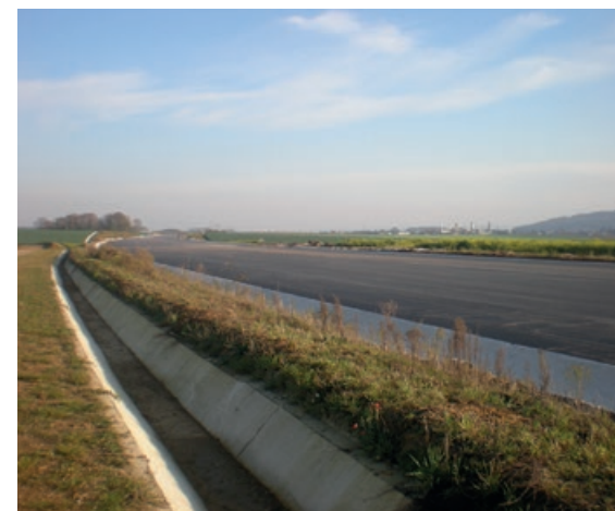
Fossé de collecte des eaux de ruissellement de la chaussée. © G. de Clermont 60/ Commons.
